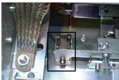
Шток электромагнита не втянут - запирающая скоба не может опуститься. (оперативное питание отсутствует)
